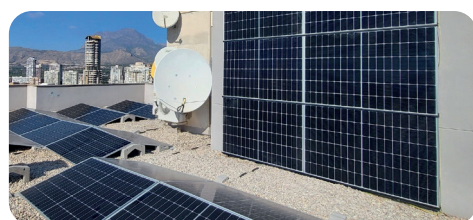
C.P. TORRES D'OBOE Benidorm. Alicante 47,56 kWp
