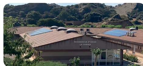
Residencia LA SABINA Albelda. Huesca 25,42 kWp
