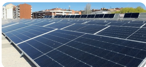
Centro Deportivo TRÈVOL Lleida 95,19 kWp
