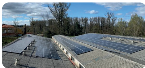
FRIOLEÓN León 107,87 kWp
