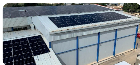
Pescados OLIVER Pollença. Mallorca. 222,87 kWp
